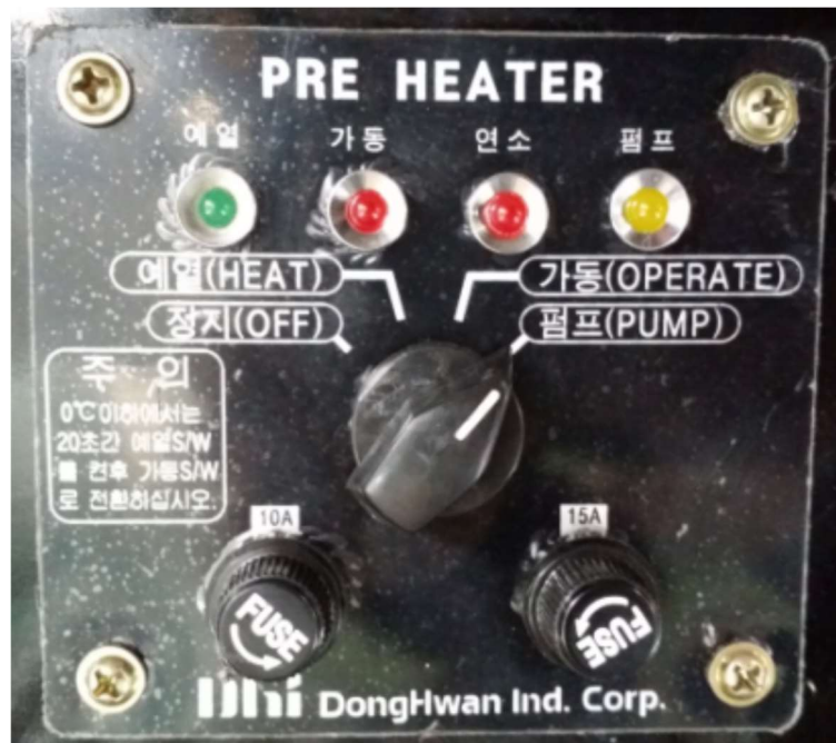
PUMP - Насос подогревателя
